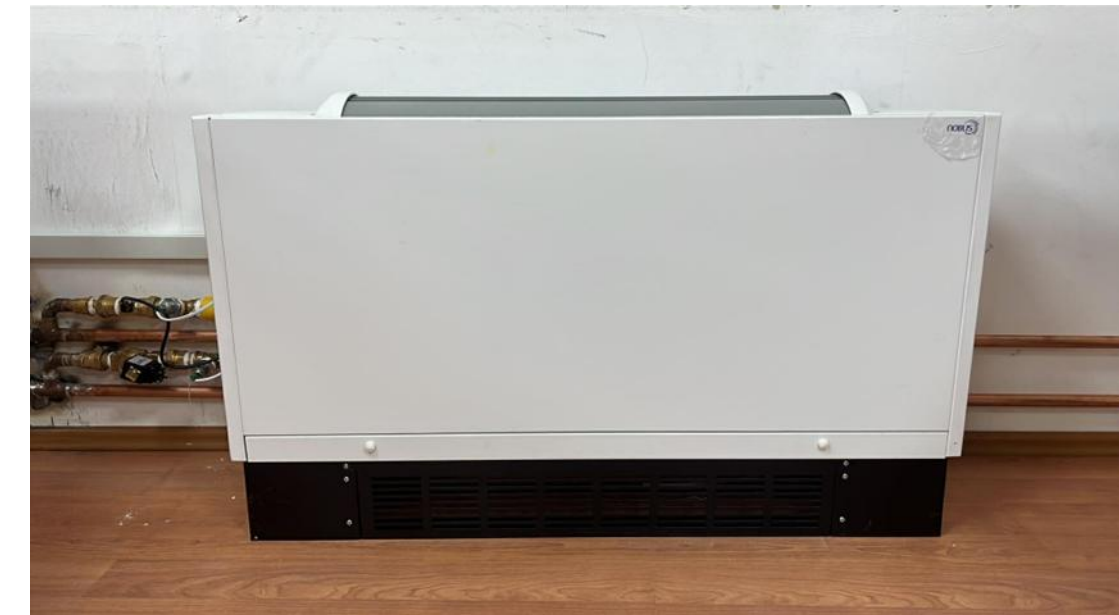
Fan coil unit
